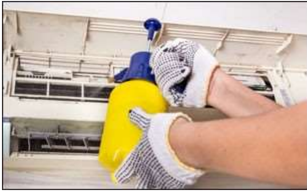
Lámparas UV, limpieza y filtros especiales para HVAC (aire acondicionado extractores, etc.)
